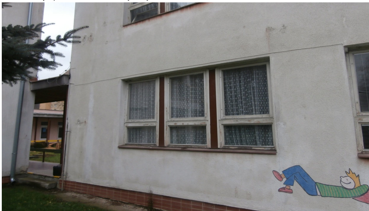
129 Vonkajší pohľad na okná z umyvárky
