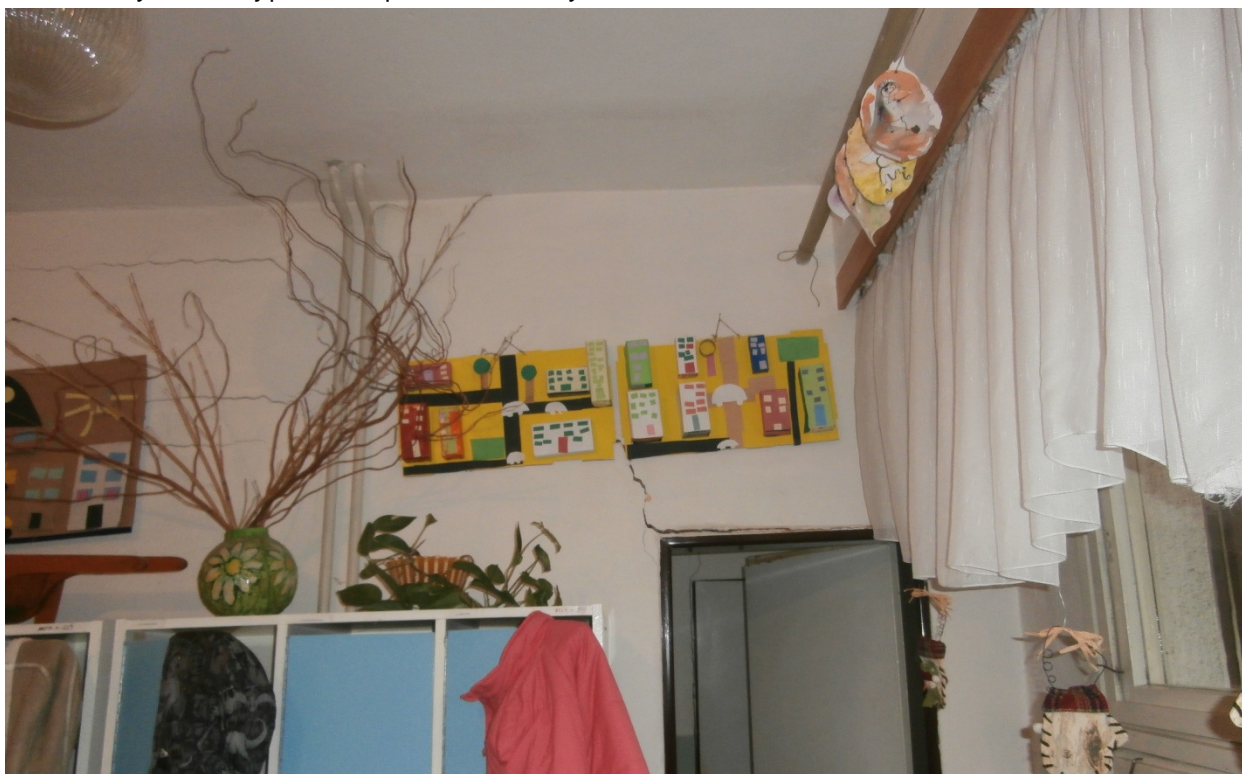
118 Trhliny v hlavnej priečke – pohľad z chodby
