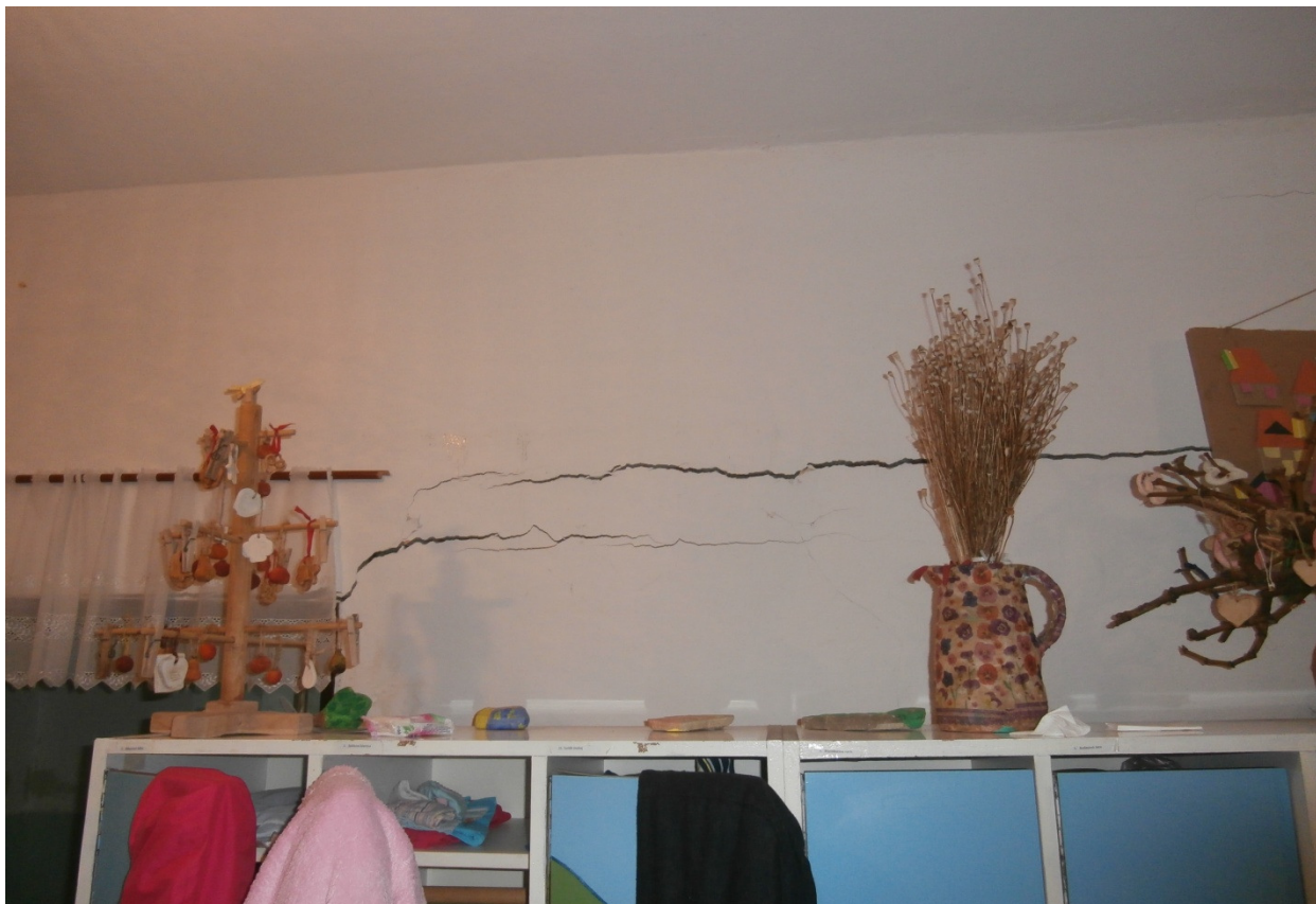
117 Trhliny v hlavnej priečke – pohľad z chodby
